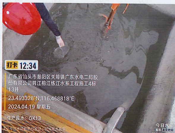
施工 4 标 GX13 生产废水
