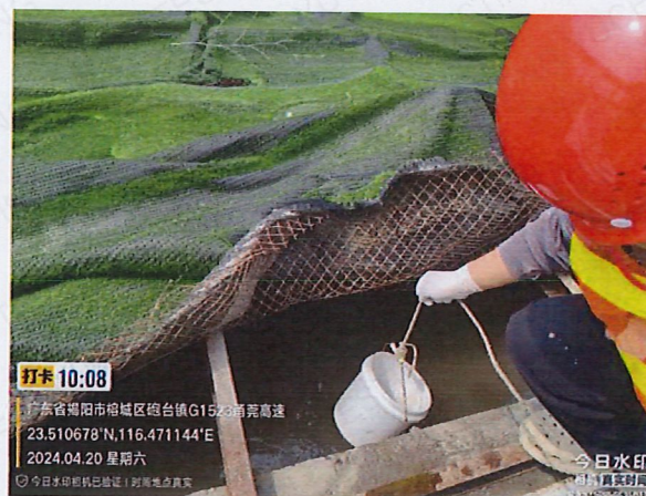
施工 2 标 GX12 生产废水
